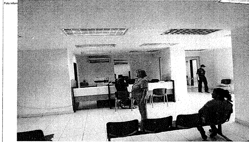
Foto inform Comentarios: SALA DE ESPERA PISOS EN REGULAR ESTADO
