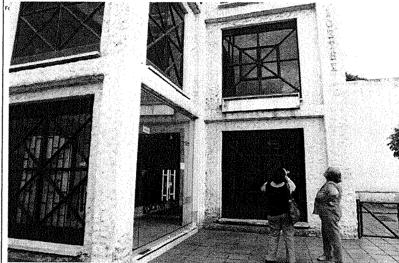
Comentarios: VIDRIOS ROTOS Y FACHADA EN MAL ESTADO
