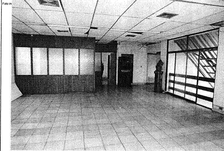
Comentarios: SEGUNDO PISO CON CIELORASOS EN PESIMO ESTADO Y PISOS DESNIVELADOS
