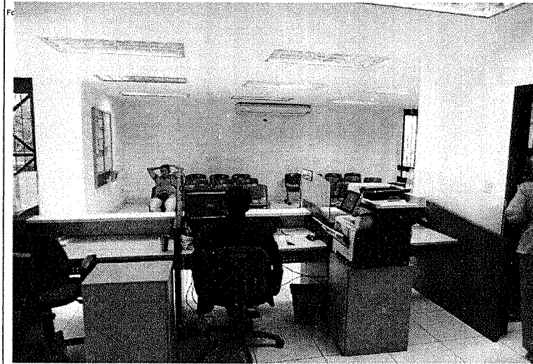
Fc Comentarios: VISTA DESDE LA ATENCION AL PUBLICO, PAREDES EN REGULAR ESTADO
